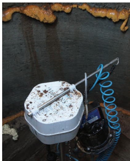
Urządzenie pomiarowe zainstalowane w jednej ze studzienek kanalizacyjnych.
